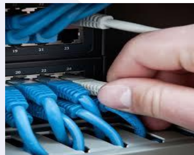
Cableado estructurado a corta distancia
